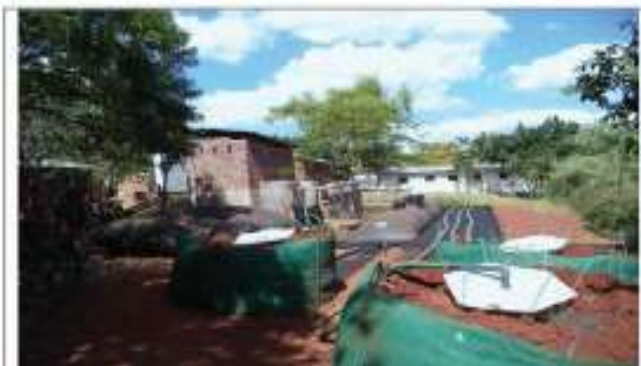
Figure 2 : Flexigester connected to pour flush toilet
